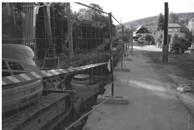
W drugiej połowie 2016 roku, równoległe z remontem ulicy Lzerskiej (wówczas Zawadzkiego), wybudowano odcinek kanalizacji. Potrzeby są jednak dużo większe.
