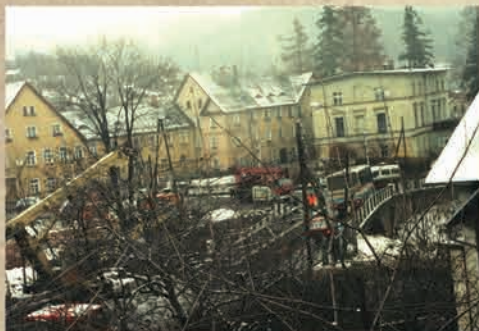
Kompleksowy remont mostu i kładki dla pieszych na rzece Kamiennej/ Piechowice Górne - 1999 r.
